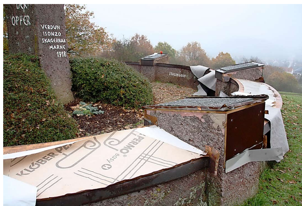
Das Ehrenmal am Friedhof in Friedensdorf wurde von Dieben heimgesucht und soll, so der Wunsch des Ortsbeirates, jetzt saniert werden. Foto: Klaus Peter
